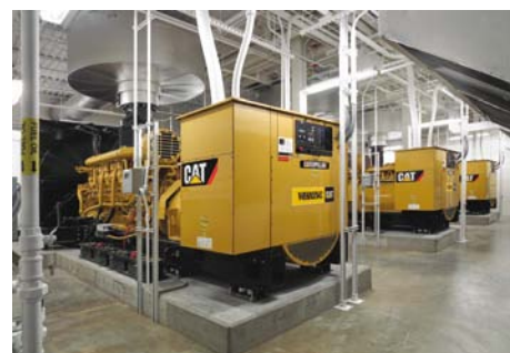
Firma Whayne Power Systems inštalovala tri dieselgenerátorové systémy Cat 3516B, ktoré v prípade výpadku verejnej siete dokážu zabezpečiť nepretržitú dodávku elektriny počas dvoch týždňov.
