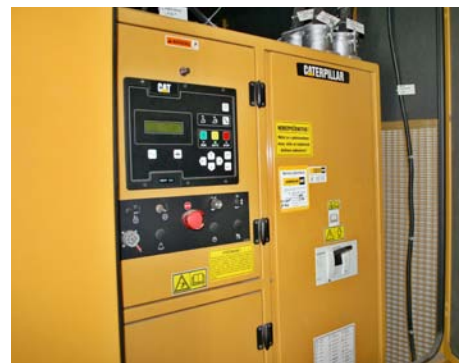
Dieselaagregát C18-605 je, spolu s RUPS 250i, súčasťou energocentra NZ 2 CP 250 od Zeppelin SK.
