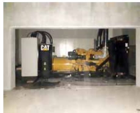
Dieselgenerátor Cat C32 1400 kVA (zdroj Zeppelin SK)
