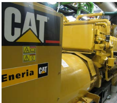
Z energie vyrobenej generátorom Caterpillar G3520E sa 95 % predáva distribučnej spoločnosti
