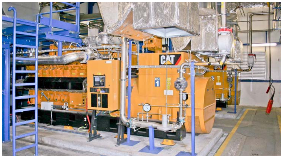
V levickom priemyselnom parku je od vlašajška nainštalovaných šesť kogeneračných jednotiek Caterpillar G3516 H – každá má výkon 2 MW.
