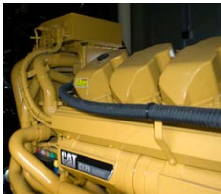
VISI zvolila na záložné napájanie 36-miliónového datacentra s certifikátom Tier III tri dieselgenerátory Cat® C175-16, každý s výkonom 3000 kW.
